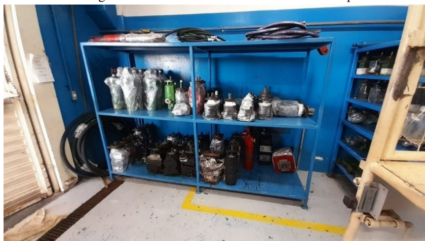
Figura 22 - Sala de hidráulica e controle de componentes
